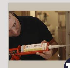
INSTALACIÓN SIN OBRA
